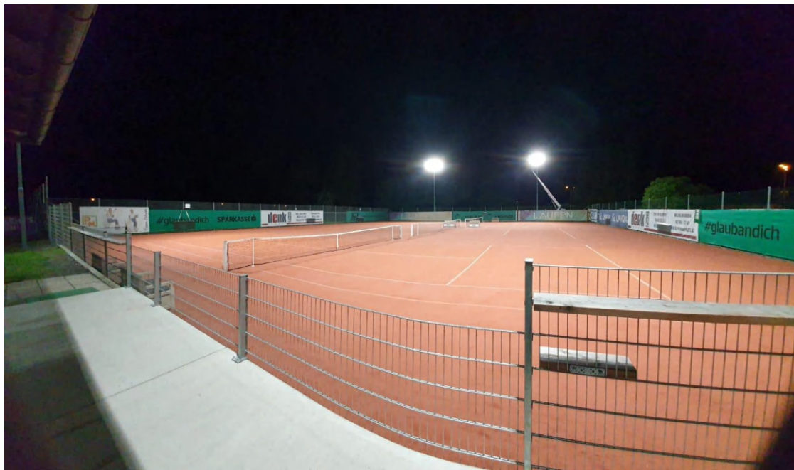
Neue LED-Paneele beim Flutlicht der Parkbadanlage
